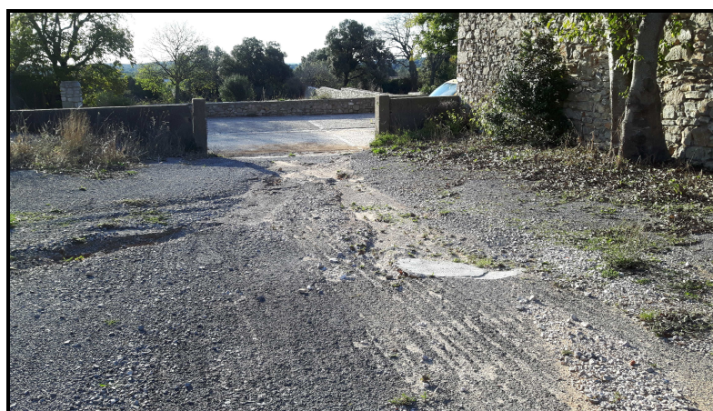
Photo de traces de ruissellement sur les BV2a et 2e
