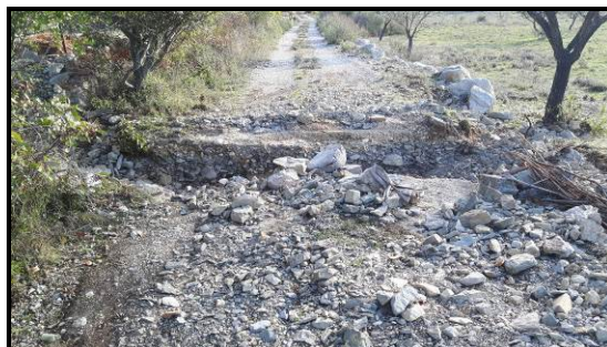
Vue d'une des ornières
